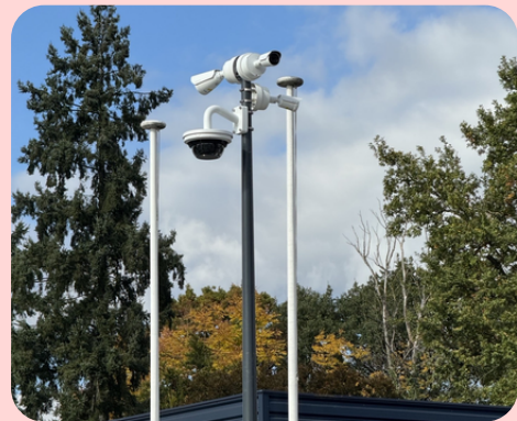
Installation du 1er site de vidéoprotection, automne 2025
